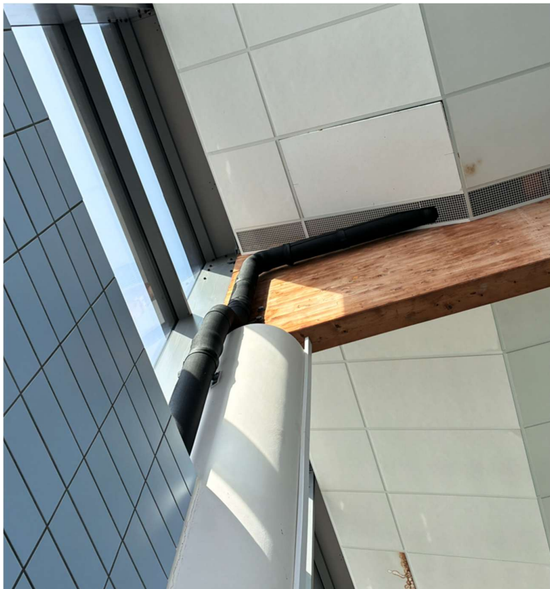
Fot. 75. Rura spustowa kanalizacji deszczowej podciśnieniowej w izolacji kauczukowej prowadzona przez halę basenową bez obudowy
