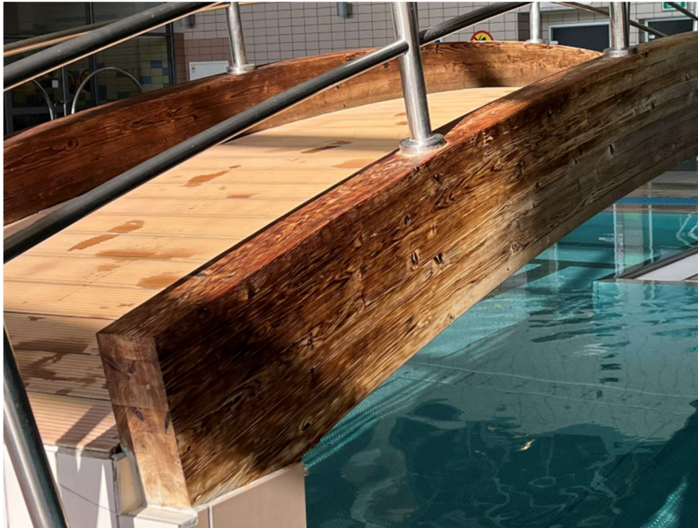
Fot. 17. Widok zmienionej powierzchni konstrukcji drewnianej mostka nad basenem
