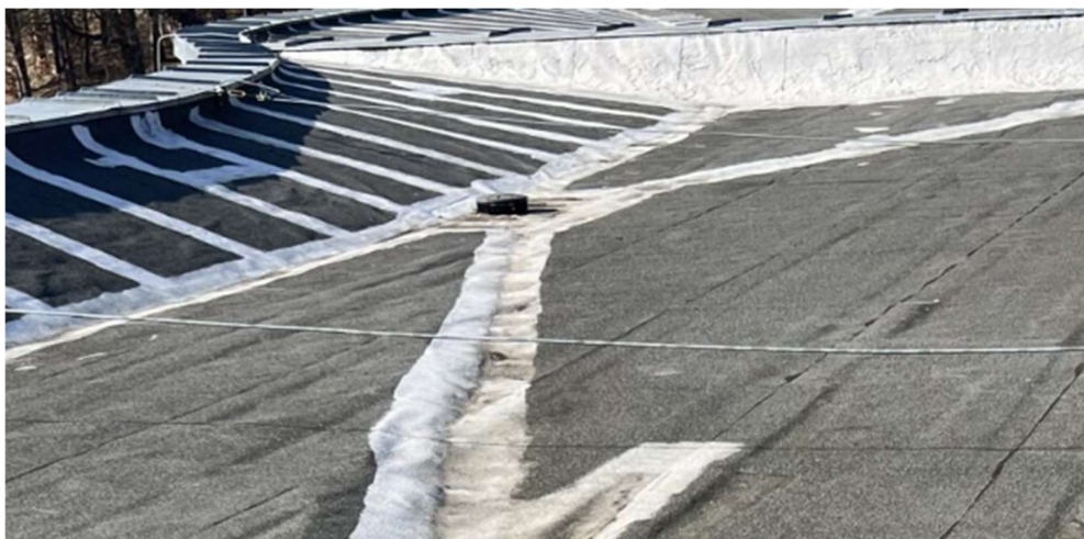
Fot. 73. Widok dachu z wpustem podciśnieniowym bez widocznego przelewu bezpieczeństwa w polu zlewowym
