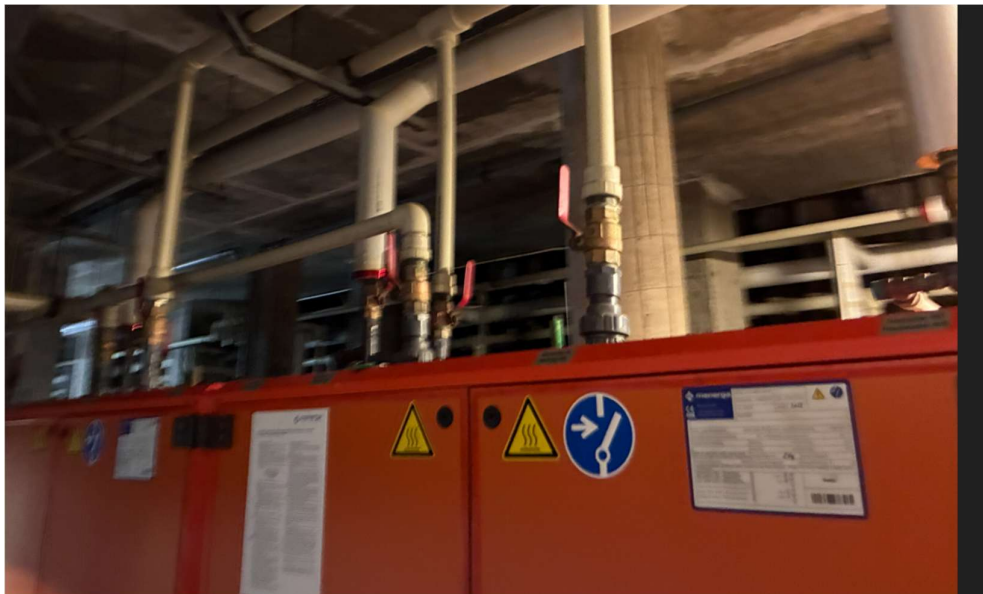
Fot. 70. Zespół odzysku ciepła ze zbiorników potucznych
