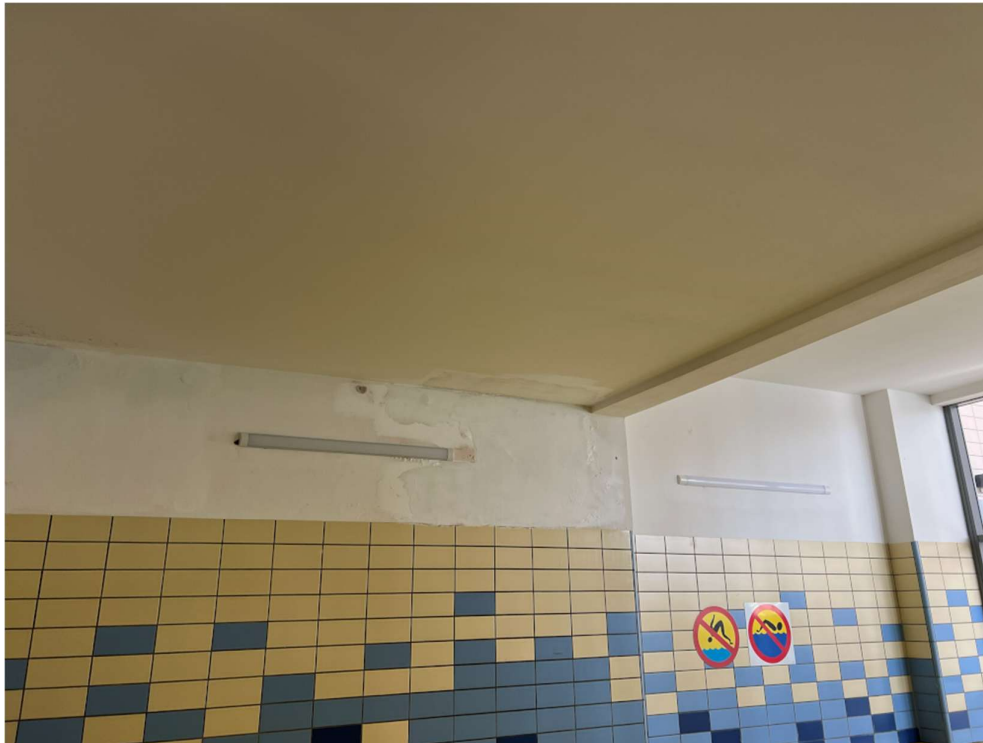
Fot. 16. Widok zawilgoconych i uszkodzonych tynków w pomieszczeniu hamowni
