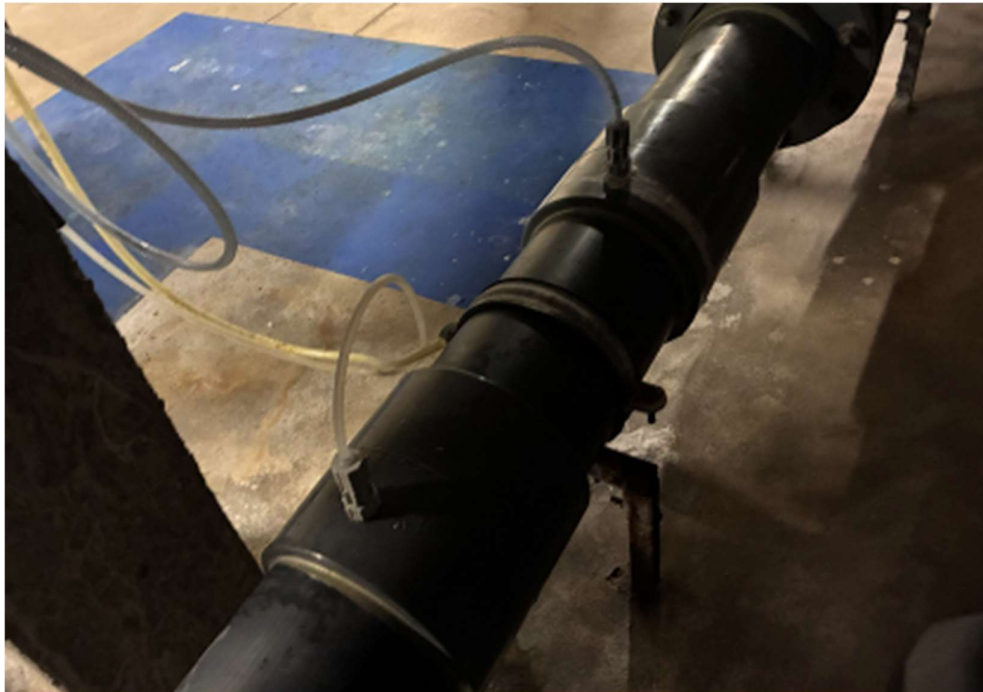
Fot. 68. Wtryskiwacz chemii basenowej na ciągu wodnym technologii basenowej pod wtryskiem widoczne uszkodzenia posadzki świadczące o częstych stanach awaryjnych.
