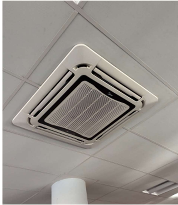
Fot. 61. Jednostka wewnętrzna klimatyzacji sali siłowni
