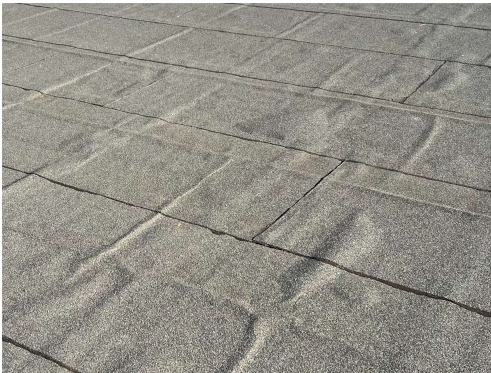
Fot. 24. Widok wierzchniej warstwy papy połałdowanej i z wybrzuszeniami
