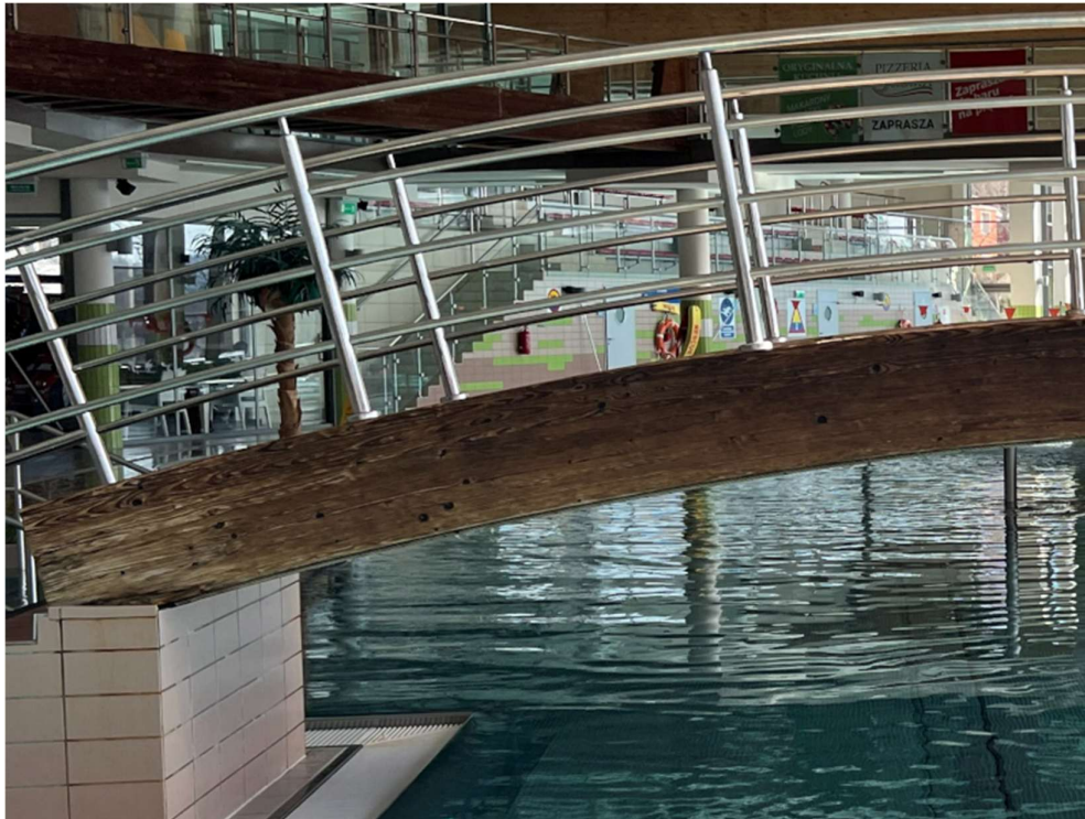
Fot. 18. Widok zmienionej powierzchni konstrukcji drewnianej mostka nad basenem
