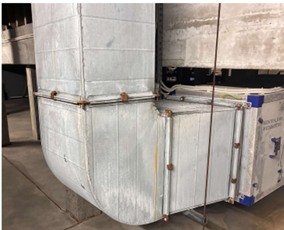
Fot. 50. Centrala wentylacyjna wywiewna podbasenia widok na podłączenie kanałów wentylacyjnych
