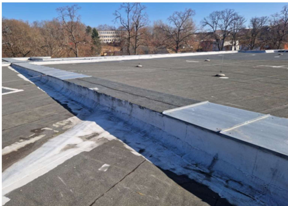
Fot. 86. Widok miejsca z brakującym odcinkiem obróbki blacharskiej
