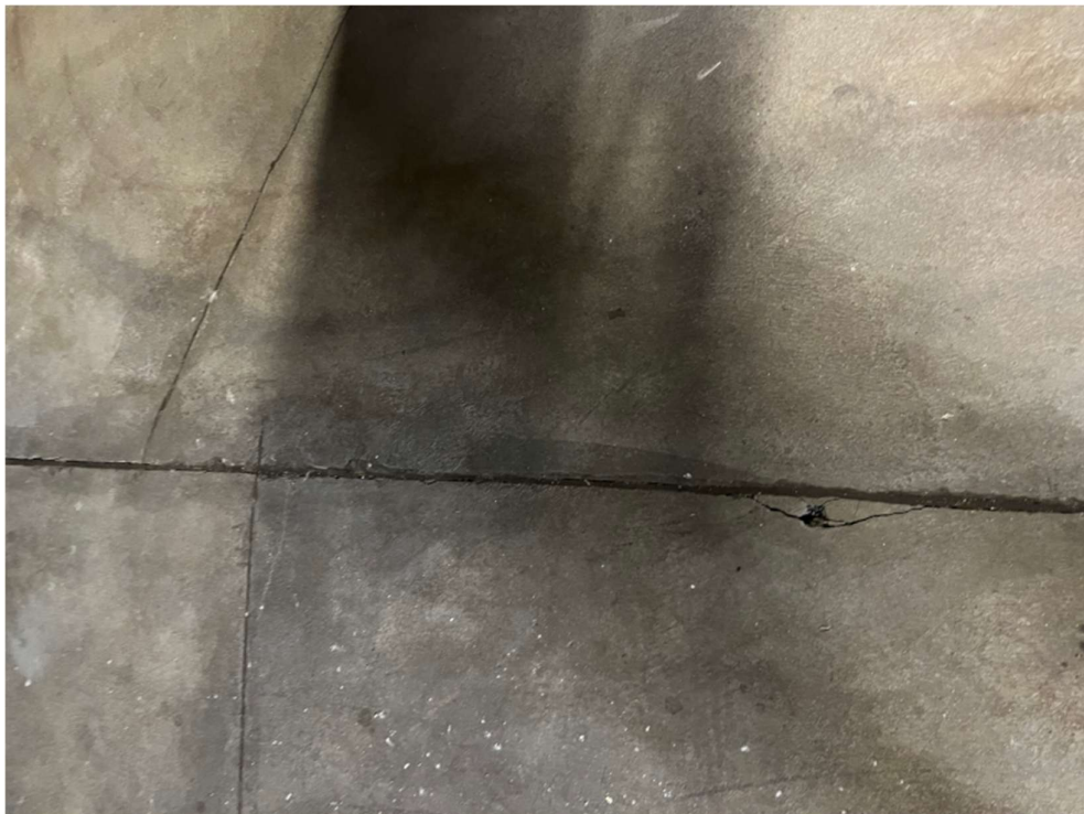
Fot. 3. Widok dylatacji posadzki podbasenia z uszkodzoną krawędzią posadzki
