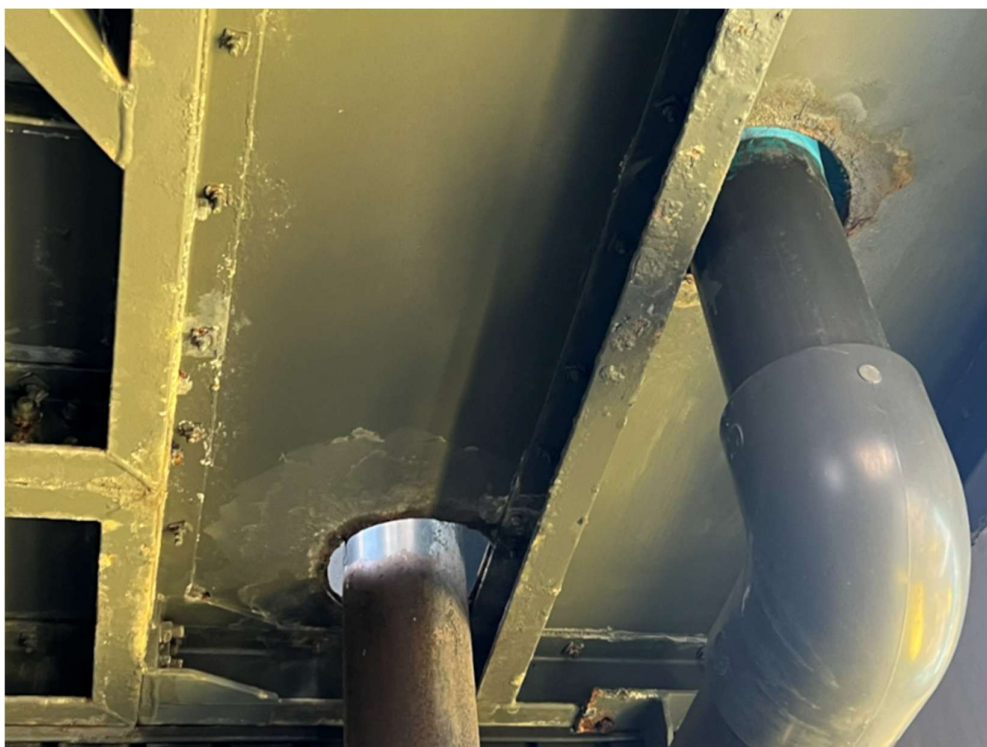
Fot. 13. Widok skorodowanej konstrukcji schodów na wieży prowadzącej na zjeżdżalnie
