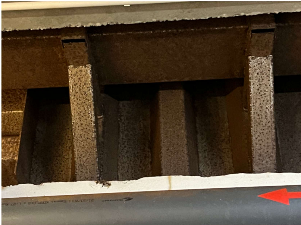
Fot. 9. Widok skorodowanej niecki basenu rekreacyjnego od strony podbasenia
