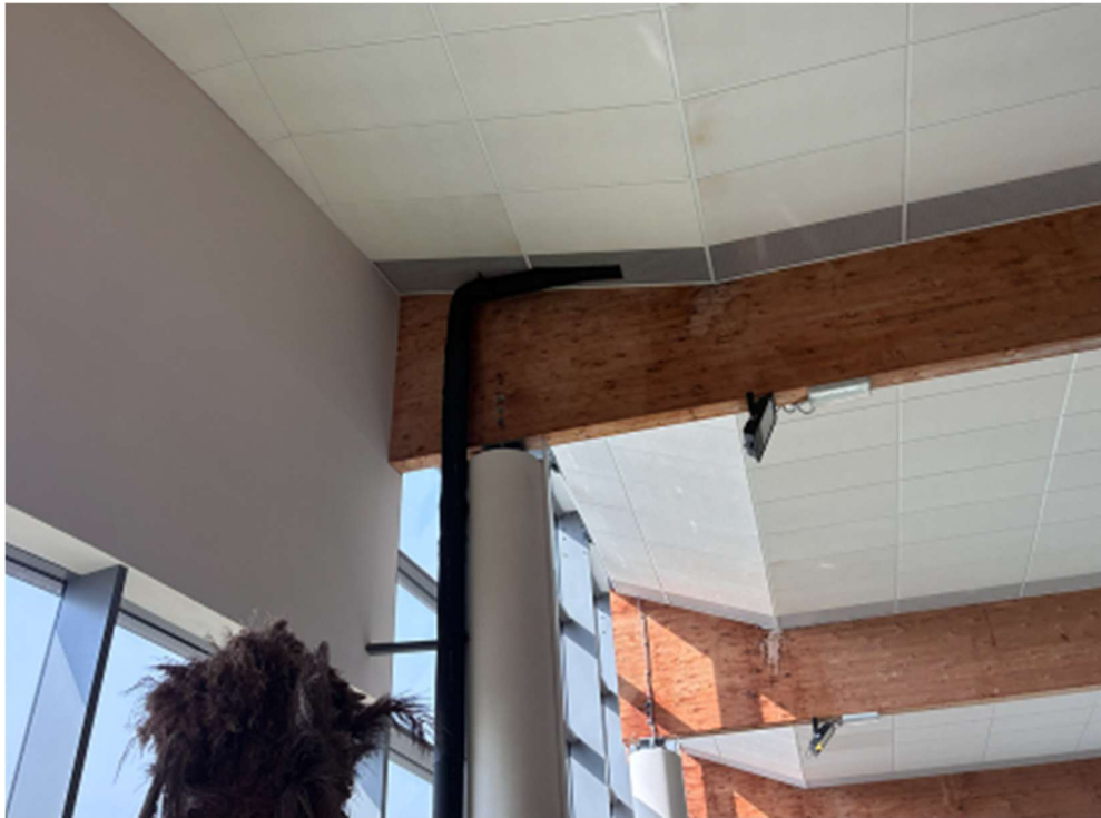
Fot. 74. Rura spustowa kanalizacji deszczowej podciśnieniowej w izolacji kauczukowej prowadzona przez halę basenową bez obudowy
