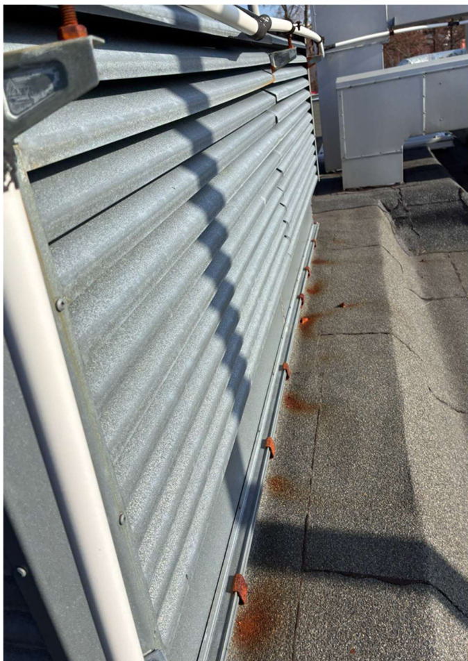
Fot. 41. Wyrzutnia dachowa wentylacji hali basenowej
