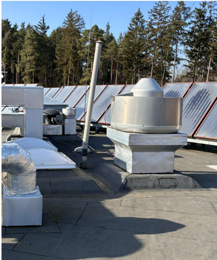
Fot. 64. Wentylator oddymiający dachowy
