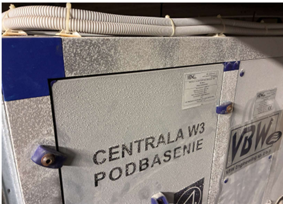
Fot. 49. Centrala wentylacyjna wywiewna podbasenia, widoczne utlenione elementy obudowy centrali wentylacyjnej
