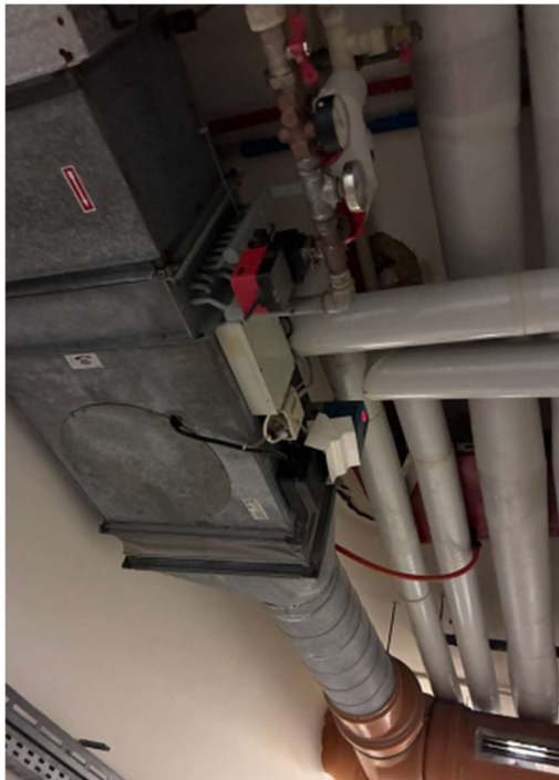
Fot. 57. Centrala went. nawiewna dla pomieszczeń chemii basenowej
