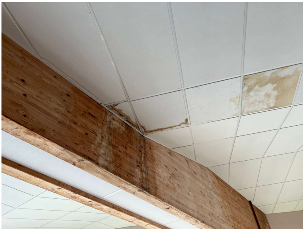
Fot. 30. Widok wiązara i sufitu akustycznego z zaciekami w hali basenowej w miejscu istniejącej attyki, na połączeniu dwóch wiązarów dachowych
