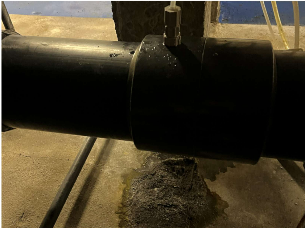
Fot. 5. Widok przeciekających wtrysków i skorodowanej posadzki betonowej w pomieszczeniu podbasenia
