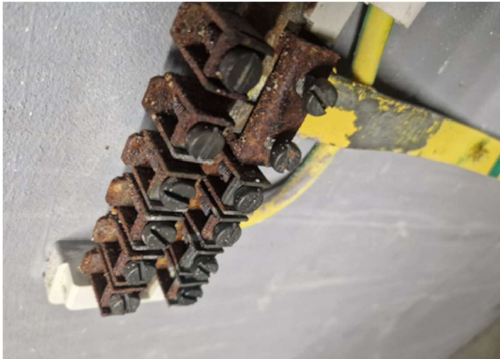
Fot. 80. Korozja na szynie wyrównawczej
