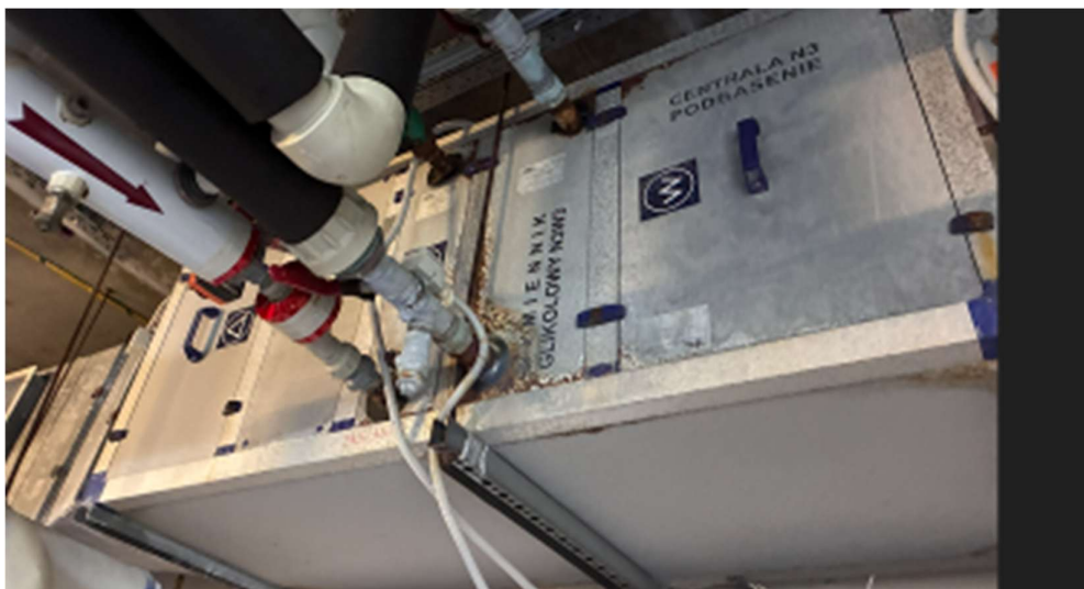
Fot. 51. Centrala wentylacyjna nawiewna podbasenia
