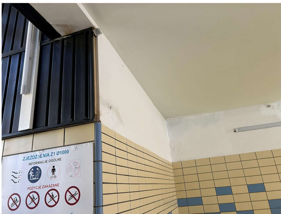
Fot. 15. Widok zawilgoconych i uszkodzonych tynków w pomieszczeniu hamowni
