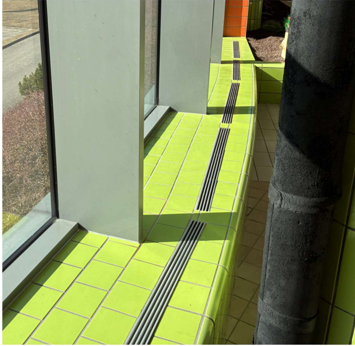
Fot. 42. Nawiewniki szczelinowe
