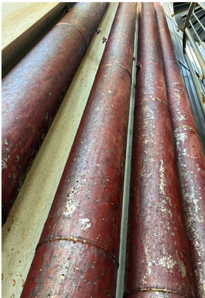
Fot. 45. Rurociągi wentylacji nawiewnej wieży zjeżdżalni
