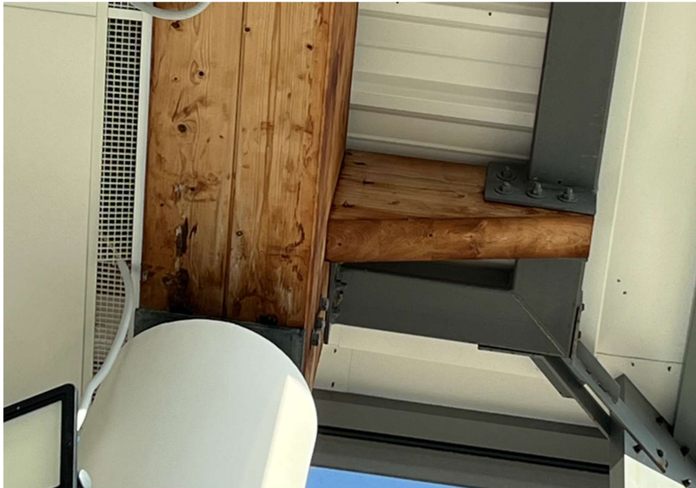
Fot. 43. Widok wiązara z zaciekami w południowo wschodniej części hali basenowej
