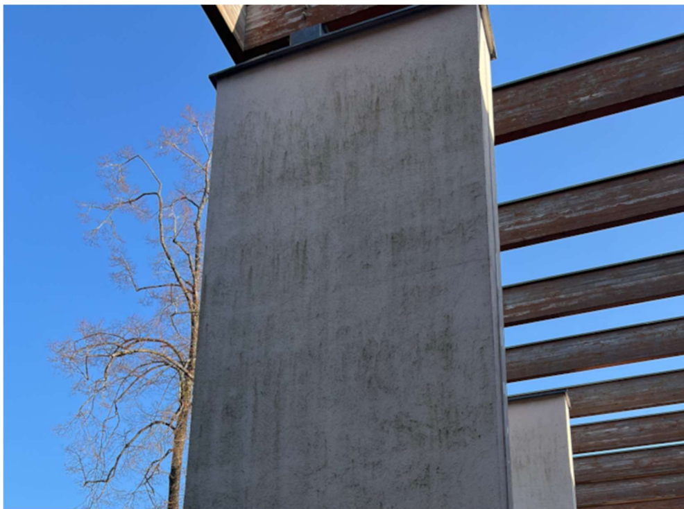
Fot. 33. Widok elewacji przy wejściu do budynku basenu z widocznym nalotem
