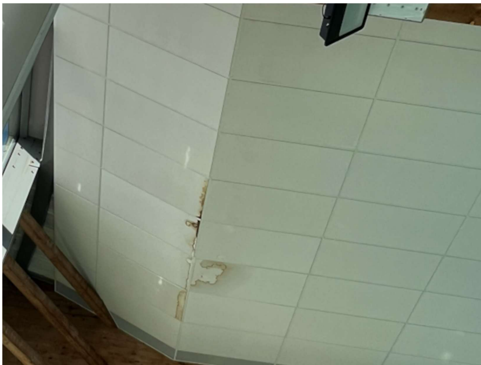
Fot. 27. Widok sufitu akustycznego z zaciekami w hali basenowej
