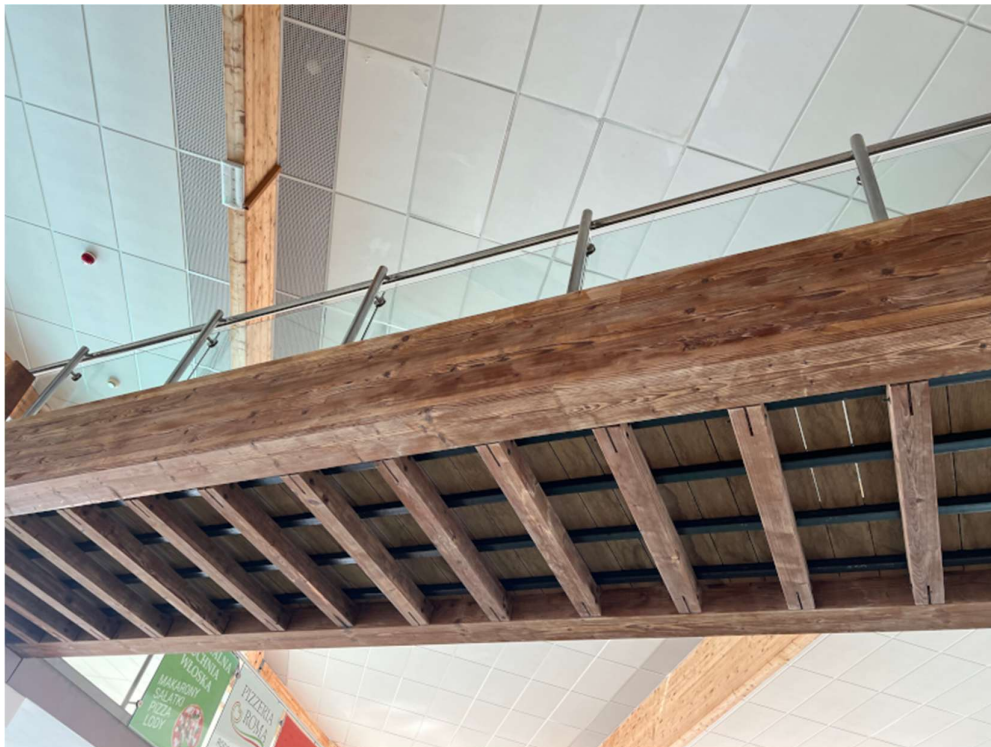
Fot. 19. Widok zmienionej powierzchni konstrukcji drewnianych kładki
