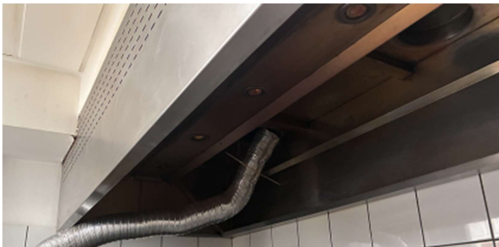
Fot. 65. Okap część kuchenna baru
