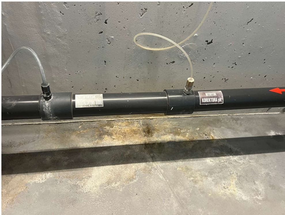
Fot. 6. Widok miejsc po przeciekach wtrysków i widok skorodowanej posadzki betonowej na podbaseniu
