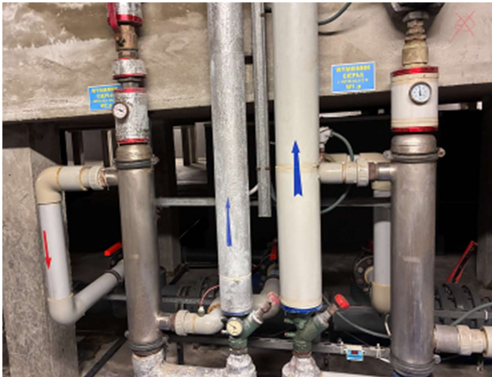
Fot. 71. Wymienniki ciepła basenu kąpielowego
