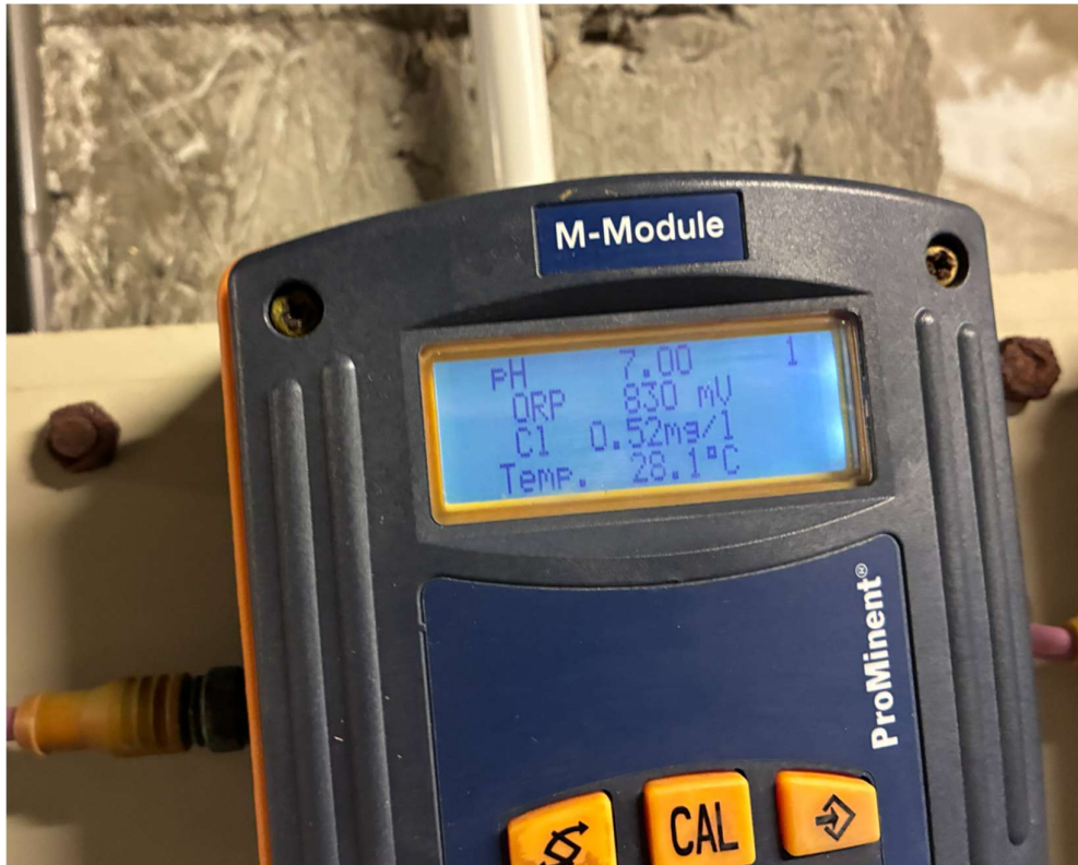
Fot. 67. Urządzenie pomiarowo dozujące chemii basenowej
