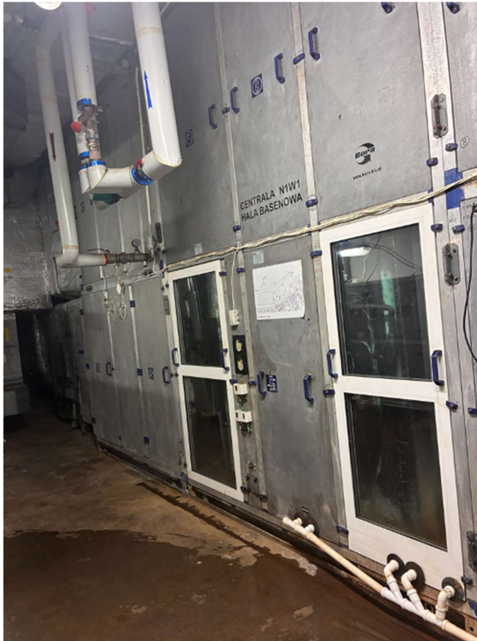
Fot. 37. Widok centrali basenowej układu C1. Widoczne przeszklone sekcje pompy ciepła oraz wentylatora wyciągowego
