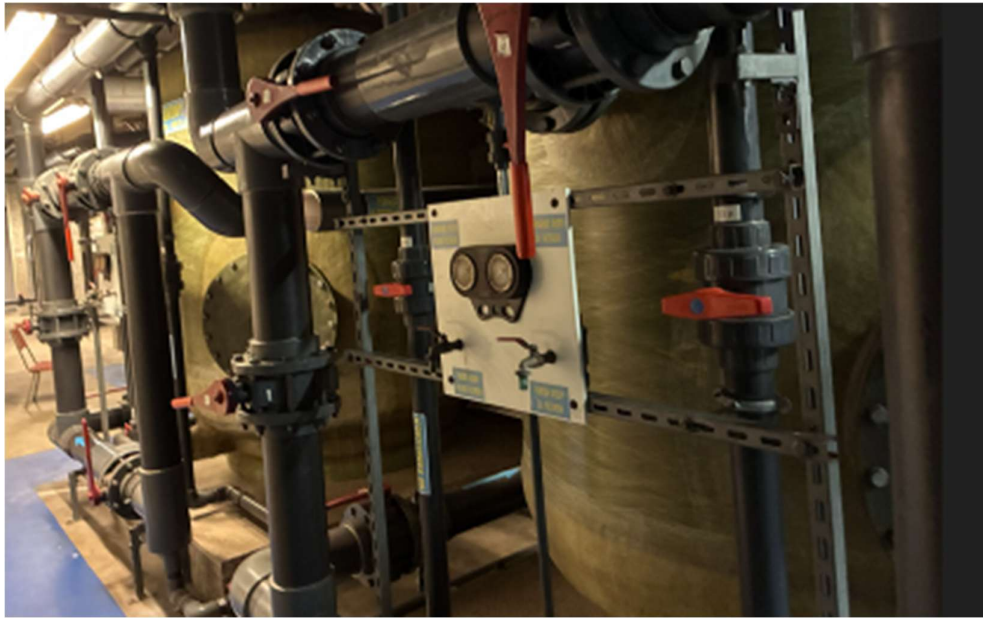
Fot. 69. Filtry wody basenowej
