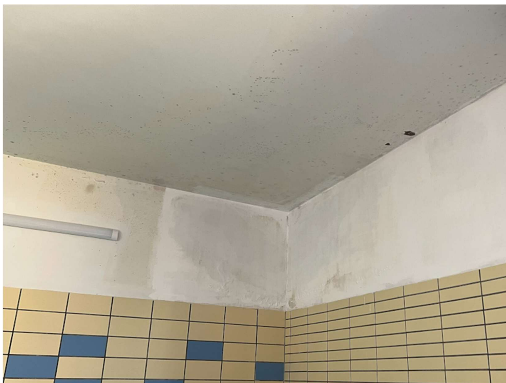
Fot. 14. Widok zawilgoconych i uszkodzonych tynków w pomieszczeniu hamowni
