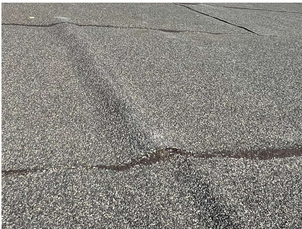
Fot. 25. Widok odspojonej wierzchniej warstwy papy na łączeniu dwóch pasów w miejscu sfałdowania
