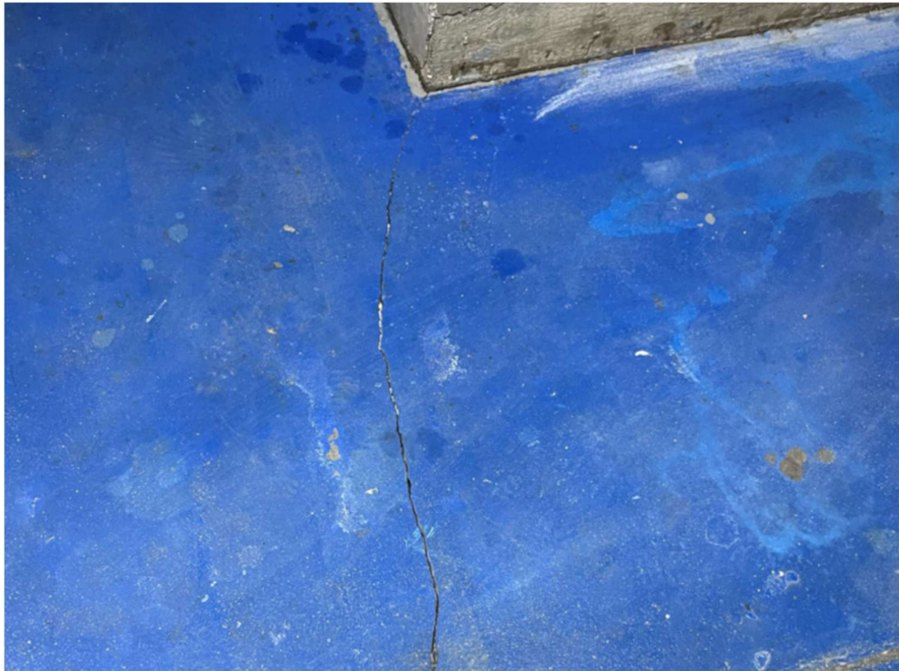
Fot. 4. Widok pękniętej posadzki podbasenia z uszkodzonymi krawędziami posadzki
