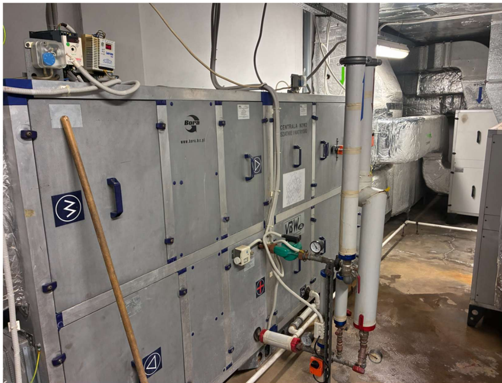
Fot. 46. Centrala wentylacyjna dla szatni i natrysków
