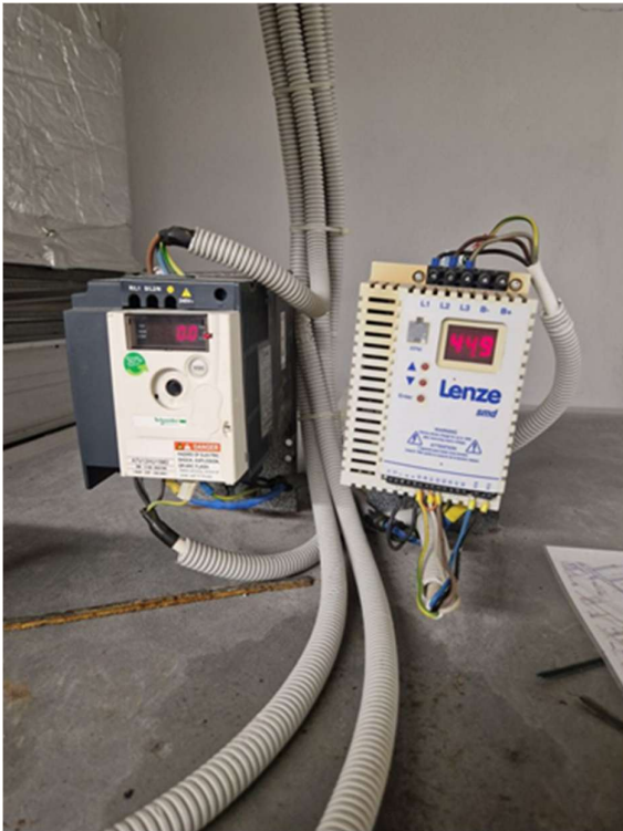
Fot. 83. Nieprawidłowy montaż falowników
