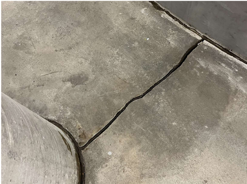
Fot. 1. Widok pękniętej posadzki podbasenia
