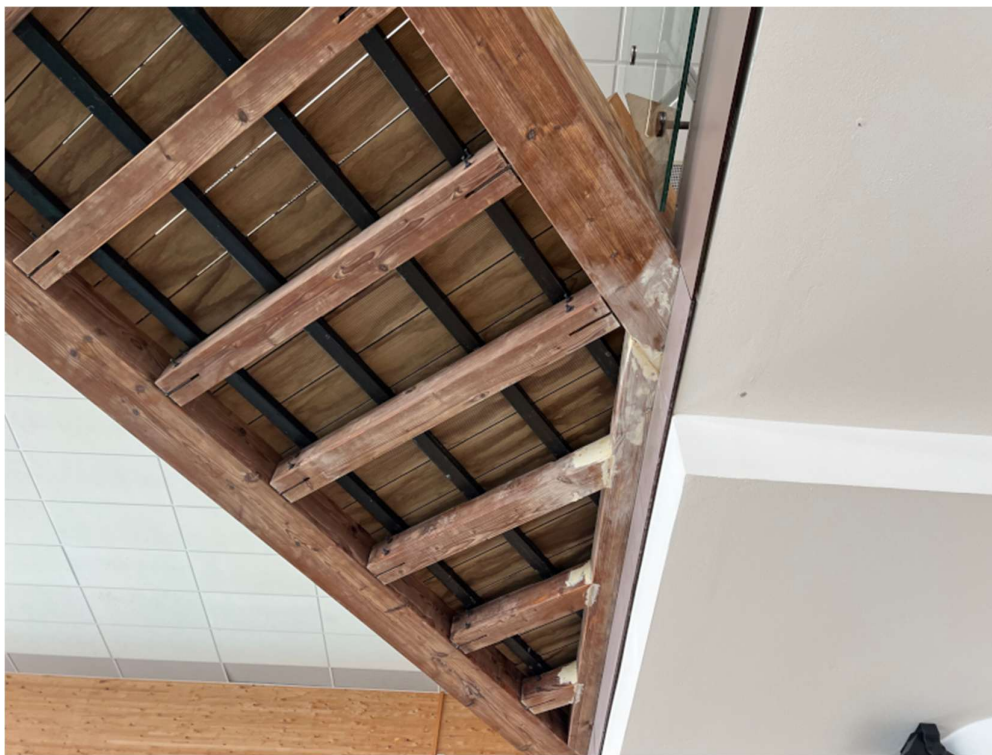
Fot. 20. Widoczne ślady napraw konstrukcji drewnianej kładki
