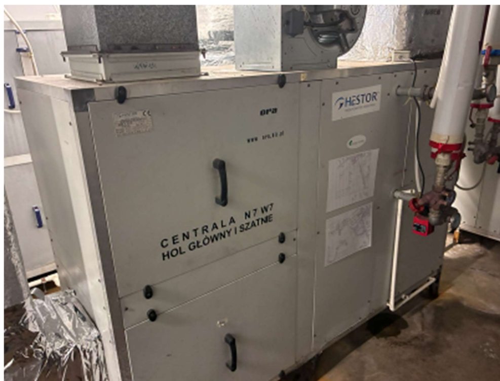
Fot. 56. Centrala wentylacyjna dla pomieszczeń holu głównego i szatni
