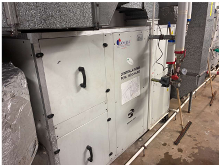
Fot. 54. Centrala wentylacyjna dla pomieszczeń socjalnych na parterze
