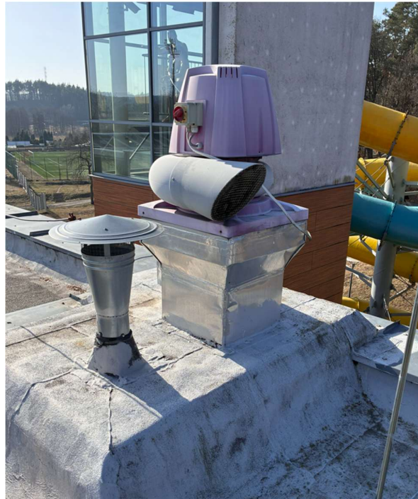
Fot. 58. Wentylator chemoodporny z pom. chemii basenowej
