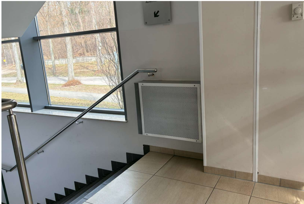
Fot. 63. Krata napowietrzająca instalacji oddymiania
