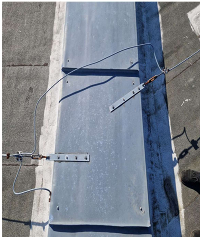
Fot. 87. Widok połączeń zwodów poziomych do obróbki blacharskiej
