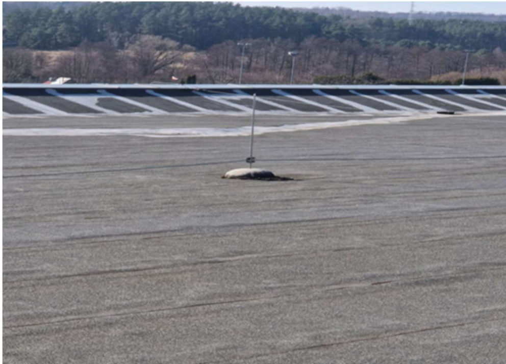
Fot. 88. Widok szpic odgromowych
