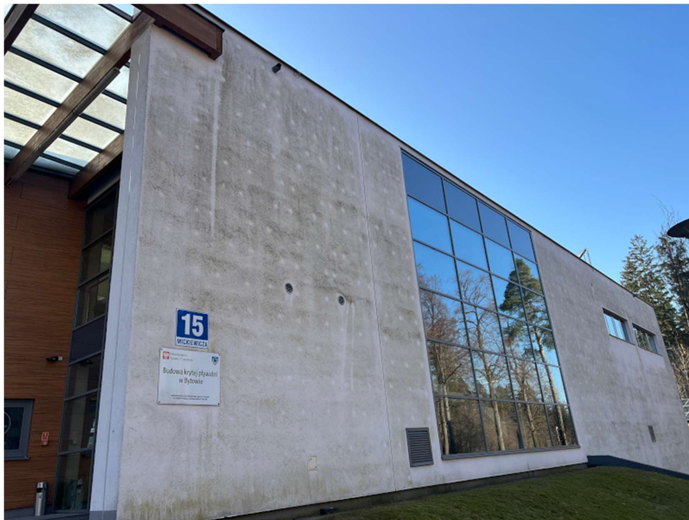
Fot. 32. Widok elewacji z widocznym nalotem od strony północno-wschodniej
