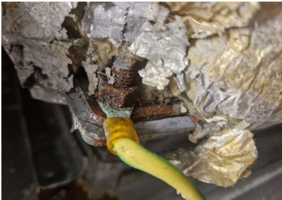
Fot. 81. Korozja na połączeniu z kanałami wentylacyjnymi
