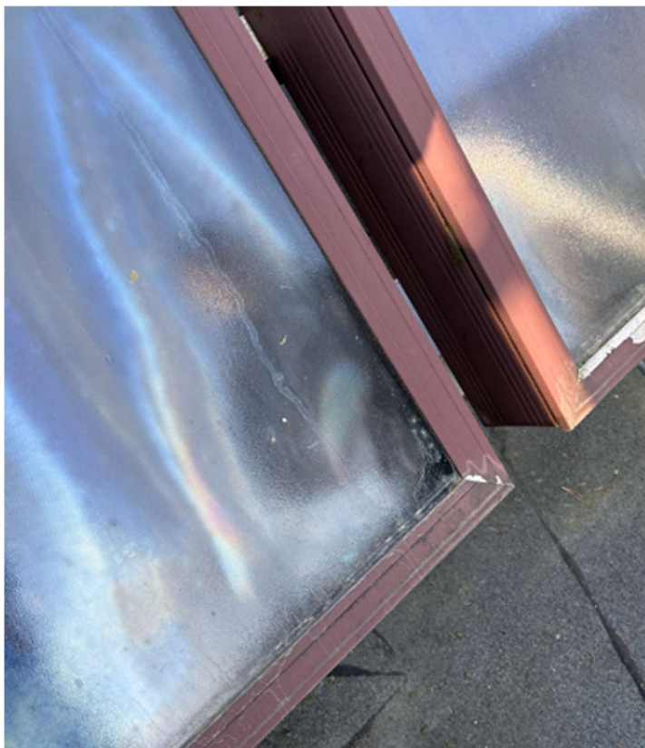
Fot. 79. Panel dachowy instalacji solarnej podgrzewania c.w.u. w basenie posiadający ślady korozji.
