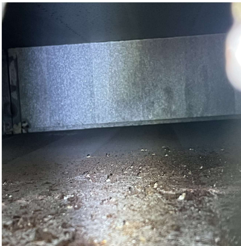
Fot. 39. Widok kanału wentylacyjnego wewnątrz ze śladami korozji przy zakończeniu kanału
