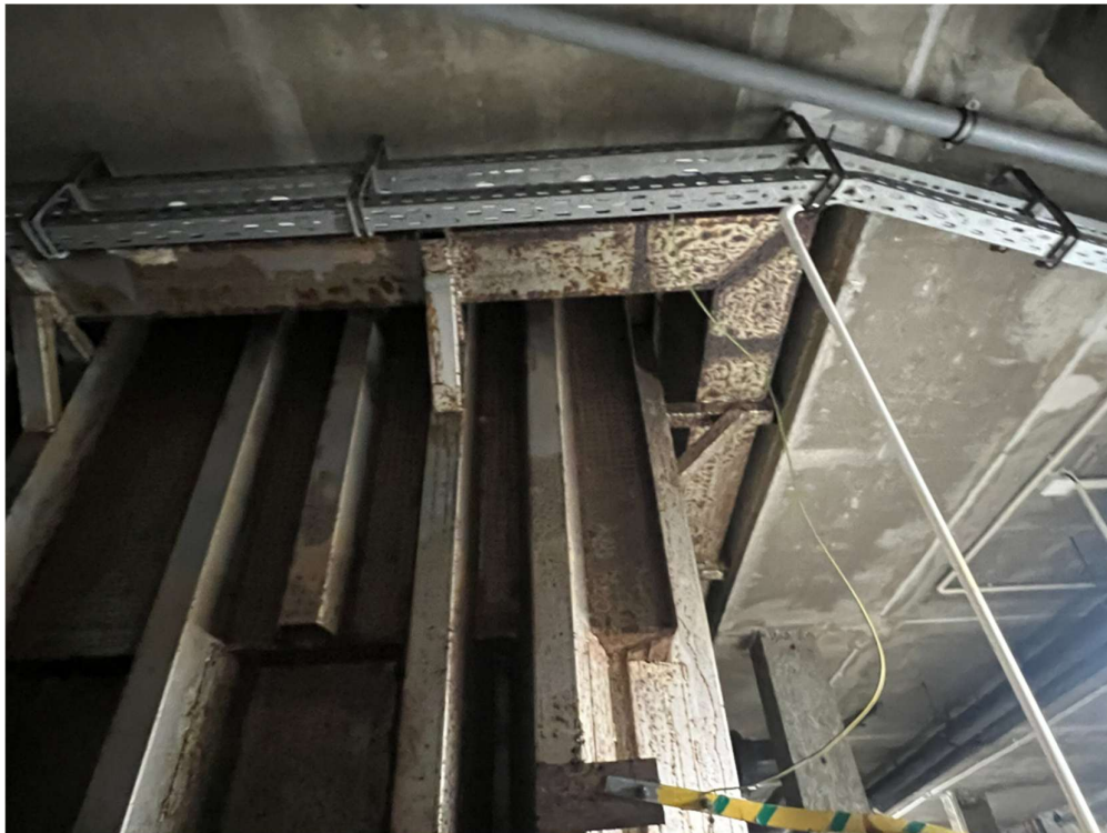
Fot. 7. Widok skorodowanej niecki basenu sportowego od strony podbasenia
