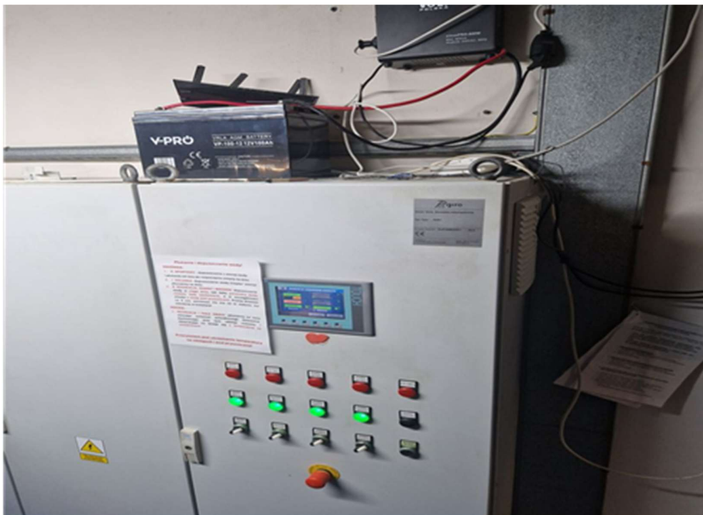
Fot. 84 Urządzenia sieciowe położone na akumulatorze
