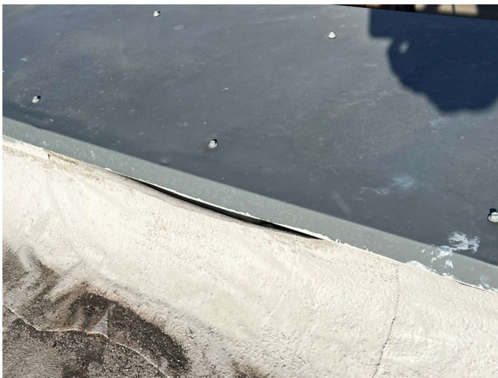
Fot. 31. Widok attyki z odspojoną warstwą papy
