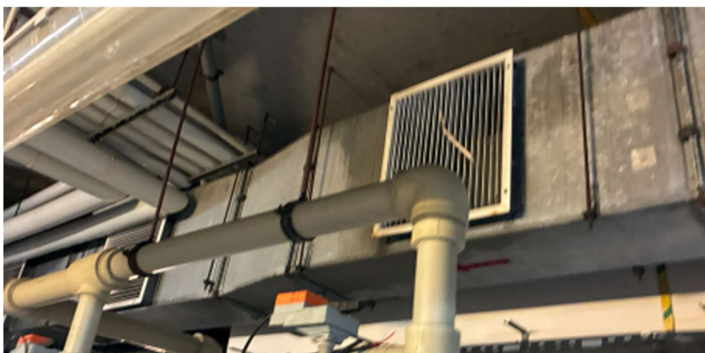
Fot. 52. Centrala wentylacyjna nawiewna podbasenia - widok na kratki nawiewne
