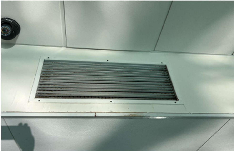
Fot. 40. Kratka wentylacyjna wyciągowa na hali basenowej
