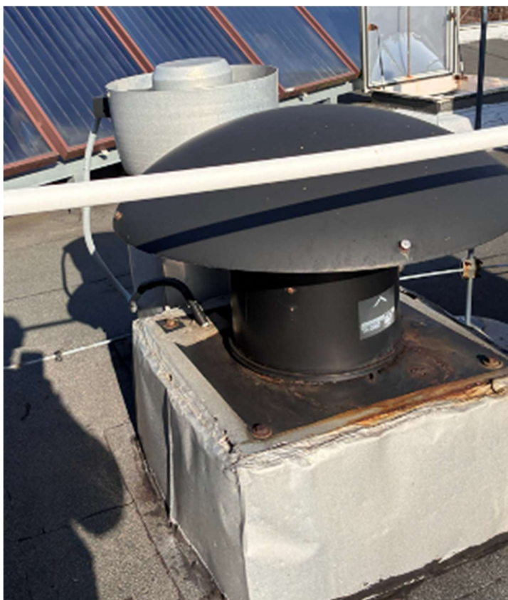
Fot. 66. Wentylator wywiewny okapowy z części kuchennej
