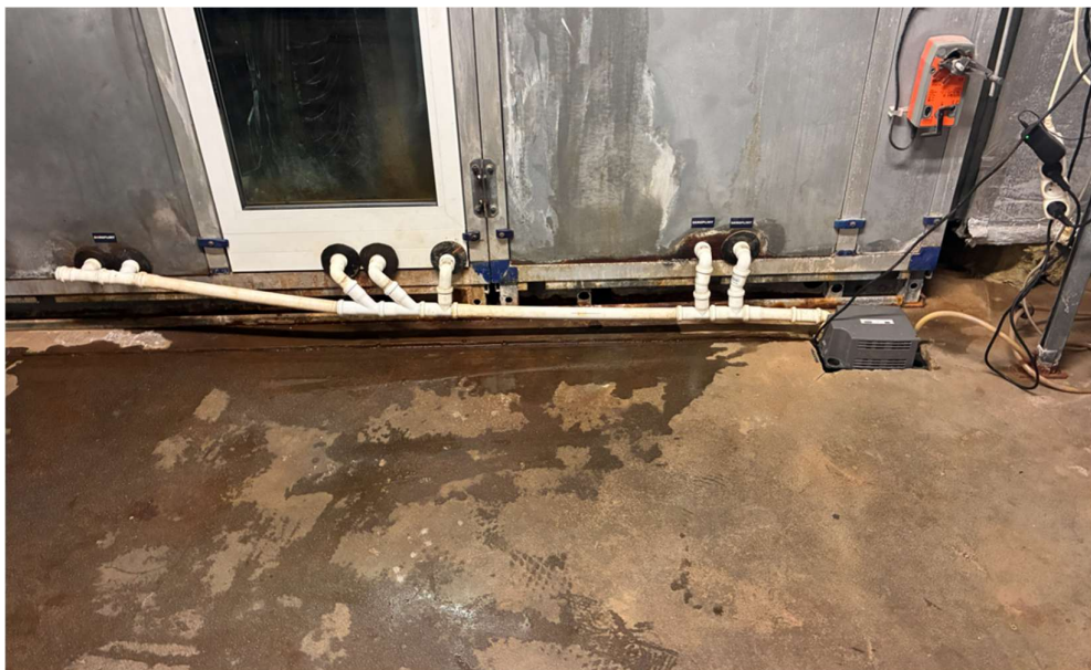
Fot. 38. Odprowadzenie skroplin z centrali wentylacyjnej
