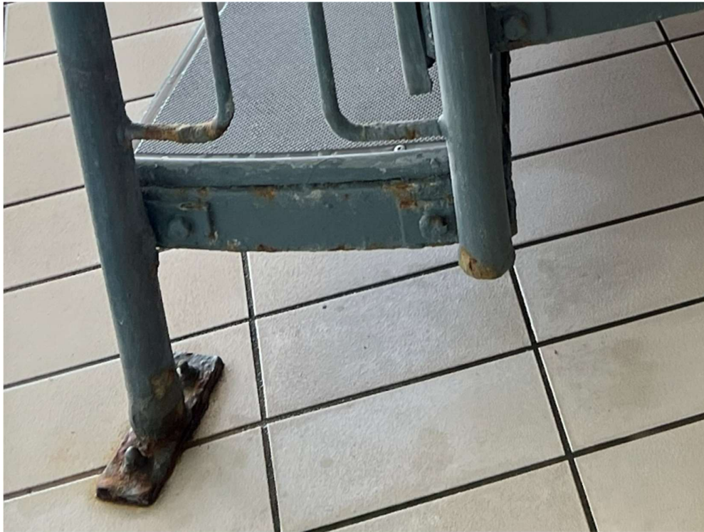
Fot. 10. Widok skorodowanej konstrukcji schodów prowadzących na zjeżdżalnie rodzinną
