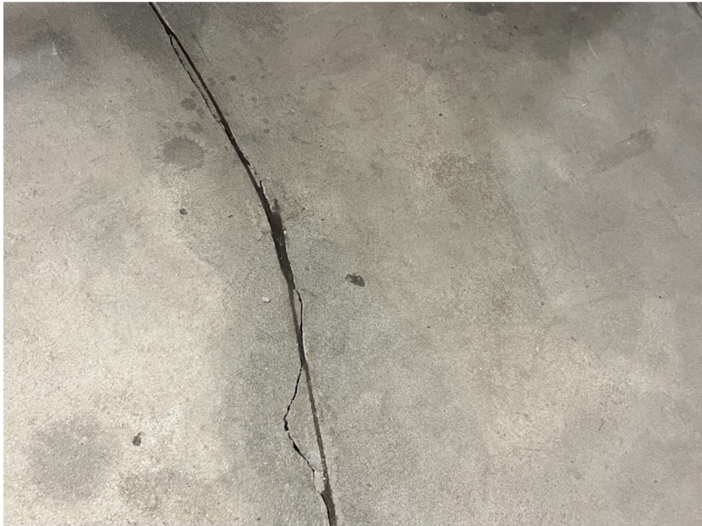
Fot. 2. Widok dylatacji posadzki podbasenia z uszkodzonymi krawędziami posadzki
