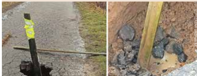
Woda podmyła drogę powiatową do Rokicin
