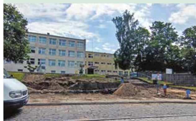
Budowa zatoki przy Szkole Podstawowej nr 5 opóźni się z powodu wykrycia płytko zakopanej rury od instalacji gazowej
