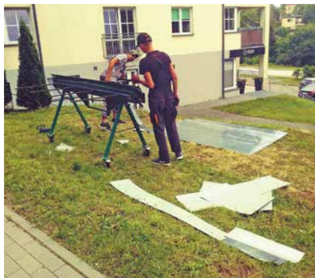
Mieszkańcy bloku przy ulicy Pochylej 34 narzekają, że po 12 latach musieli wydać 30 tys. zł na naprawę dachu
