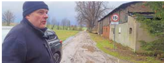
Jedyna posesja w Nowym Karwnie. Tu kończy się najgorszy odcinek gminnej drogi, którego Bielińscy nie remontowali
