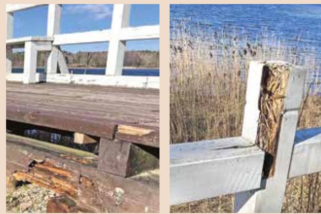
Pomost nad jeziorem Jeleń jest obecnie w fatalnym stanie
