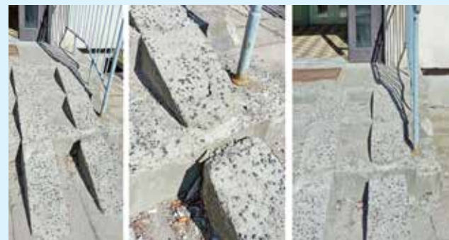
Czytelniczka wysłała zdjęcia uszkodzonych schodów w szpitalu
