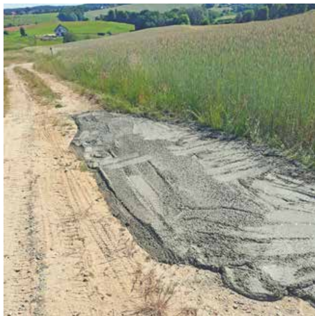
Na gruntowy odcinek ulicy Sowiej w Udorpiu ktoś wylał beton
