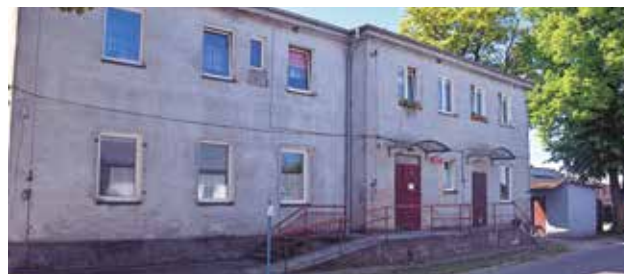
Budynek w którym jest biblioteka nadaje się do kompleksowego remontu
