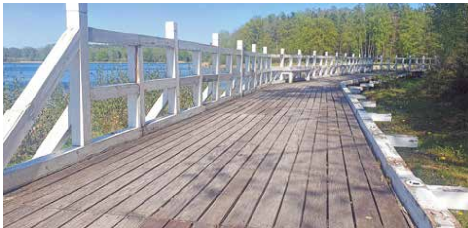
Na promenadzie usunięto barierki, bo zgniły. Podobnie jak zbudowany ok. 10 lat temu pomost
