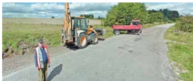
Dzięki wsparciu gminy Bytów zmodernizowana ma być m.in. droga powiatowa Pomysk Mały – Soszyca / FOT. ARCHIWUM
