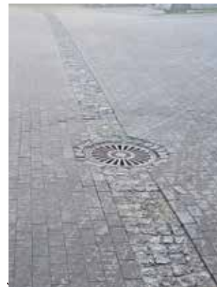
Z powodu ciężkiego transportu zarwana została podobno studzienka
