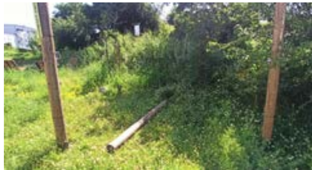
W takim stanie technicznym był słup zamontowany 2 lata temu na terenie Parku Sąsiedzkiego. Całkowicie spróchniał
