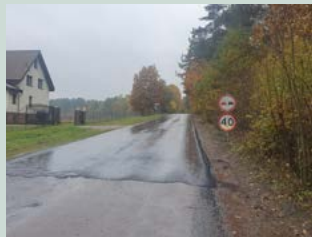
W okresie najbliższych 13 miesięcy wykonany zostanie ostatni odcinek drogi z Rokit do Pomyska Wielkiego
