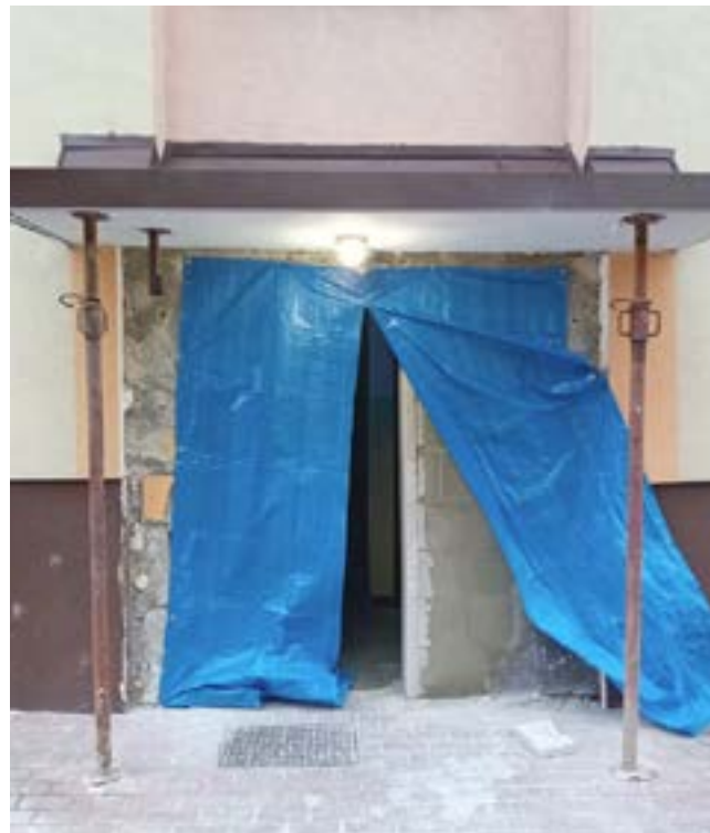
Po kolizji Forda Rangera ze ścianą bloku wejście do budynku zostało tymczasowo zabezpieczone
