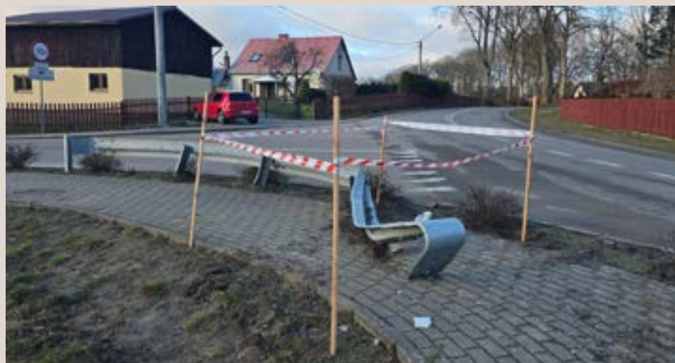
Uszkodzona bariera drogową w Grzmiącej została już wymieniona, a odłamki posprzątnięto
