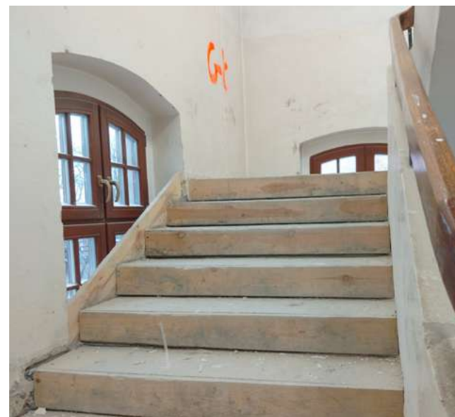
Radny Andrzej Borzyszkowski wskazuje na liczne nieprawidłowości zaistniałe podczas remontu bytowskiego zamku
