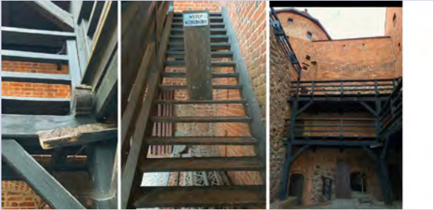
Miejsce, w którym doszło do zdarzenia z udziałem turysty, zostało zabezpieczone i tymczasowo wyłączone z użytkowania
