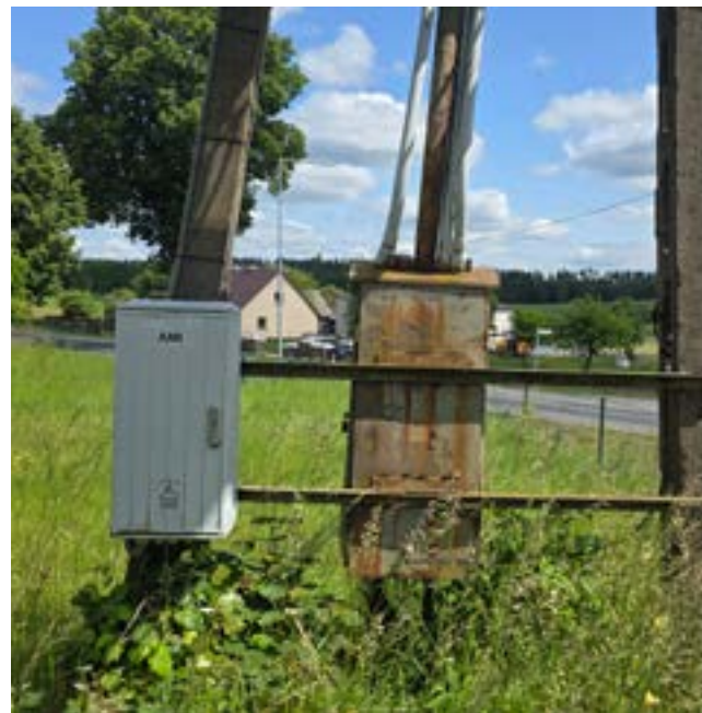
Ten zbudowany 42 lata temu transformator stał się symbolem długotrwałego sporu między 80-ltnią mieszkanką Parchowa a spółką Energa
