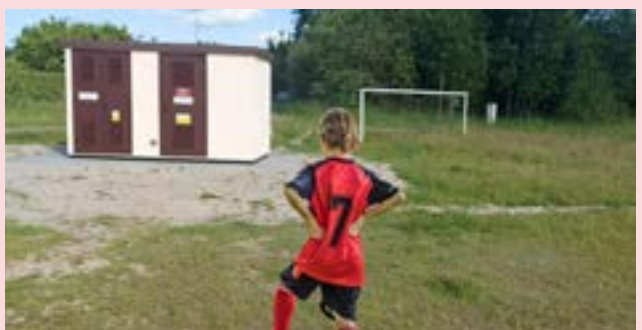
Stacja transformatorowa zbudowana na osiedlowym boisku przy ul. Kwiatowej w Bytowie
